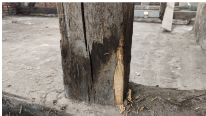
Zdj.17. Pod 3-5mm warstwą drewna o zmienionym zabarwieniu kryje się zdrowe drewno. U podstawy słupa ujawnia się jednak korozja biologiczna w postaci ciemno brązowego odbarwienia. Porażenie biokorozyjne w stopniu I. Element wymaga odgrzybiania.
