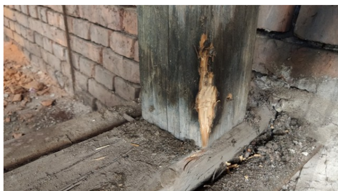
Zdj.18. Pod 3-5mm warstwą drewna o zmienionym zabarwieniu kryje się zdrowe drewno. U podstawy słupa ujawnia się jednak korozja biologiczna w postaci rozkładu białego ciemno brązowego odbarwienia. Porażenie biokorozyjne w stopniu I. Element wymaga odgrzybiania.
