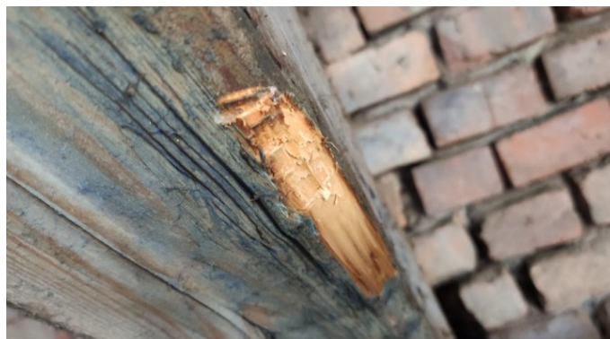
Zdj.16. Pod 3-5mm warstwą drewna o zmienionym zabarwieniu kryje się zdrowe drewno. Gdy nie ma oznak korozji biologicznej element można poddać jedynie konserwacji.
