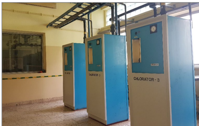
Fot. 2. Chloratory w chlorowni na terenie zbiorników Siercza
