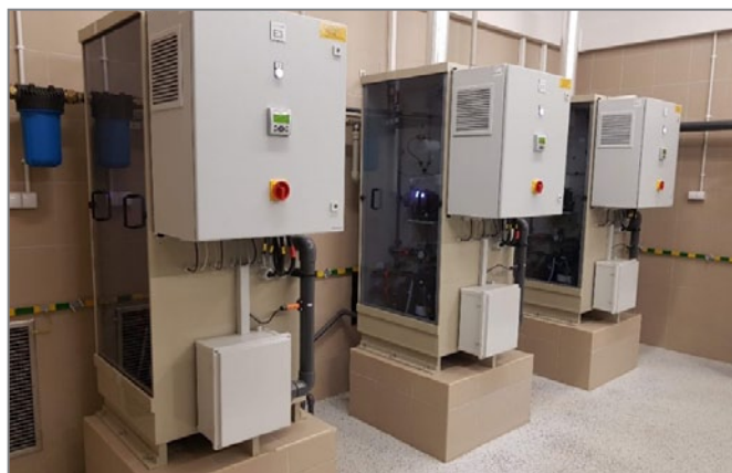
Fot. 5. Generatory podchlorynu sodu
