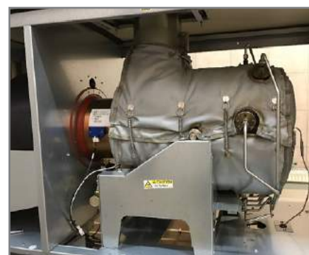
Fot. Widok wnętrza turbiny biogazowej.
