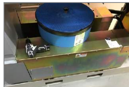
Fot. Widok układów elektronicznych służących do przetwarzania napięcia generowanego przez turbinę na napięcie sieciowe.
