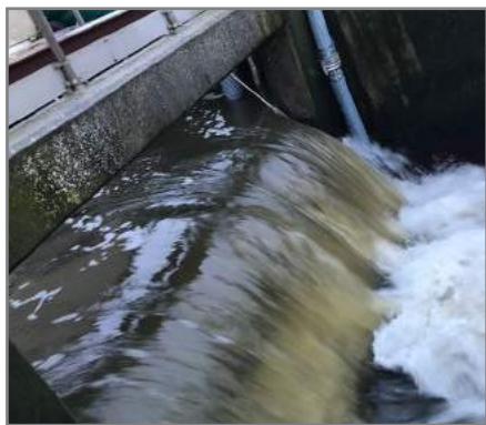
Fot. Wylot ścieków oczyszczonych z komory pomiarowej.
