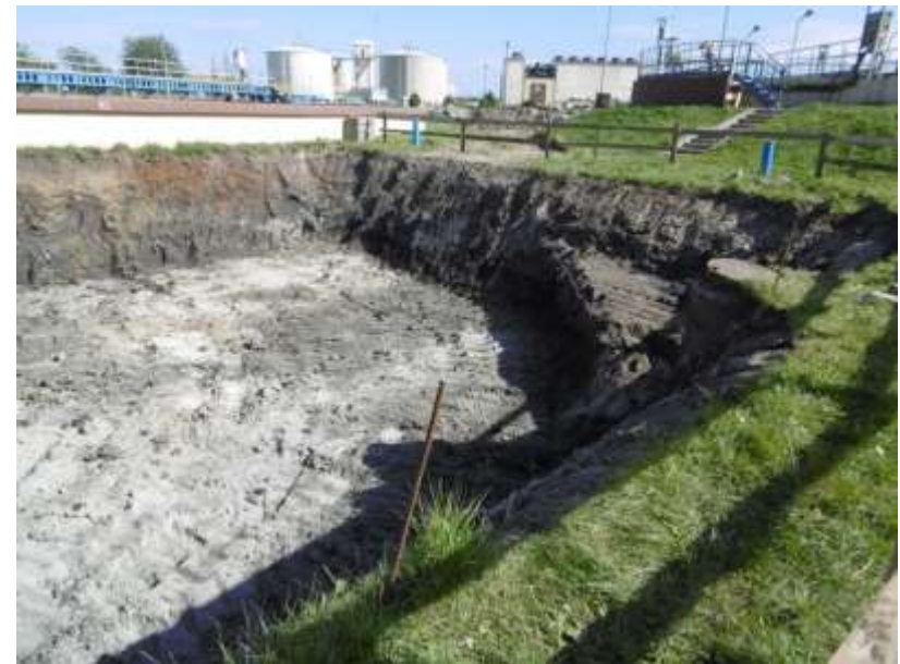
Fot.: Zakład Oczyszczania Ścieków Płaszów
